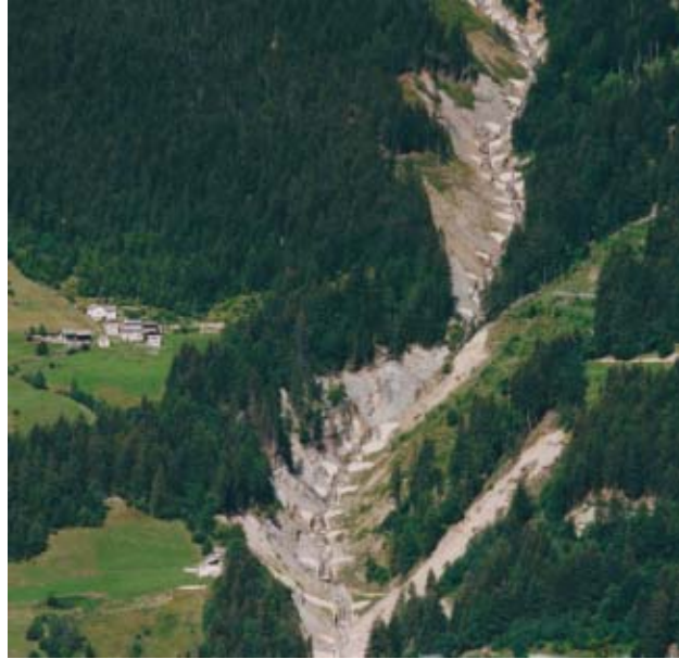
Die Kraft des Wassers zähmen: Nach den Verheerungen im Juli 1987 wurde oberhalb von Poschia- vo das Val Varuna verbaut. Bild: Tiefbauamt Graubünden
