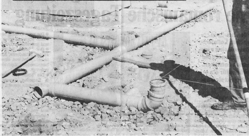
Massnahmen für mechanische Entlüftung bei einem Neubau: Ein Röhrensystem unter dem Gebäude sammelt das Radongas und gibt es über Kamine an die Atmosphäre ab.
